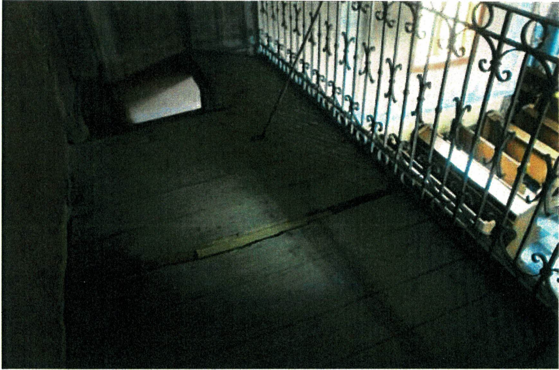
Fot. 8. Zdegradowane deski empory.
