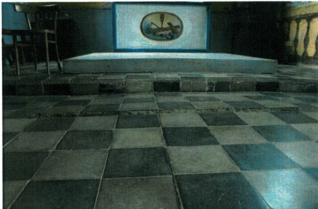
Fot. 4 Posadzka na łączeniu prezbiterium i transeptu. Bardzo wysokie i rozległe wybrzuszenie i deformacja.
