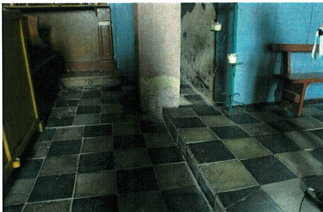
Fot. 2 Stan posadzki w transepcie i prezbiterium. Płytki zabrudzone, z wykwitami mikrobiologicznymi, z licznymi ubytkami i pęknięciami. Powierzchnia wybrzuszona i pozapadana miejscami.
