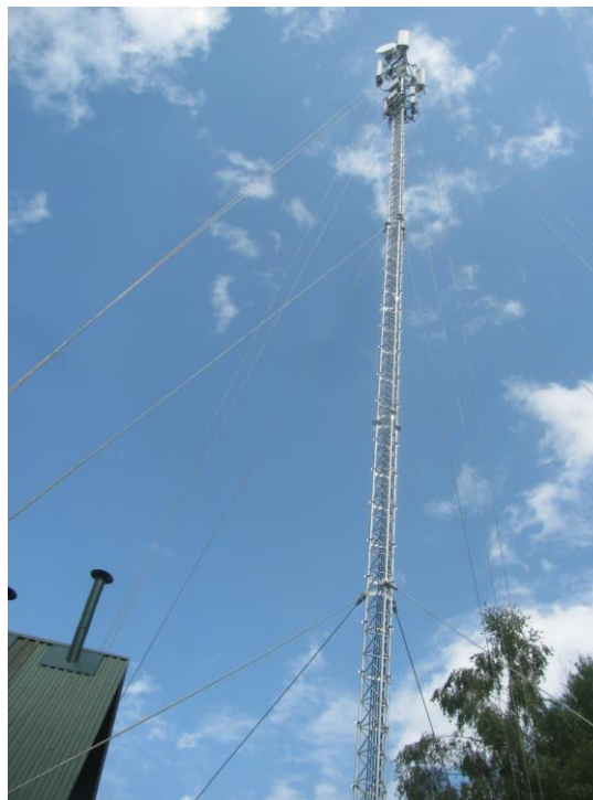
Zał. nr 1: Widok ogólny instalacji radiokomunikacyjnej.
