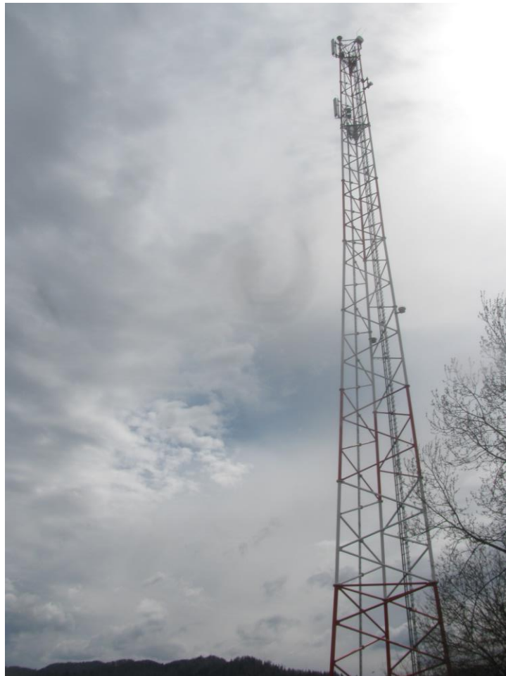
Zał. nr 1: Widok ogólny instalacji radiokomunikacyjnej.
