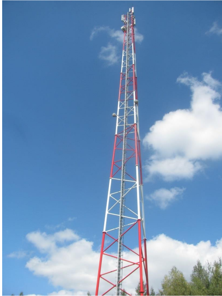
Zał. nr 1: Widok ogólny instalacji radiokomunikacyjnej.
