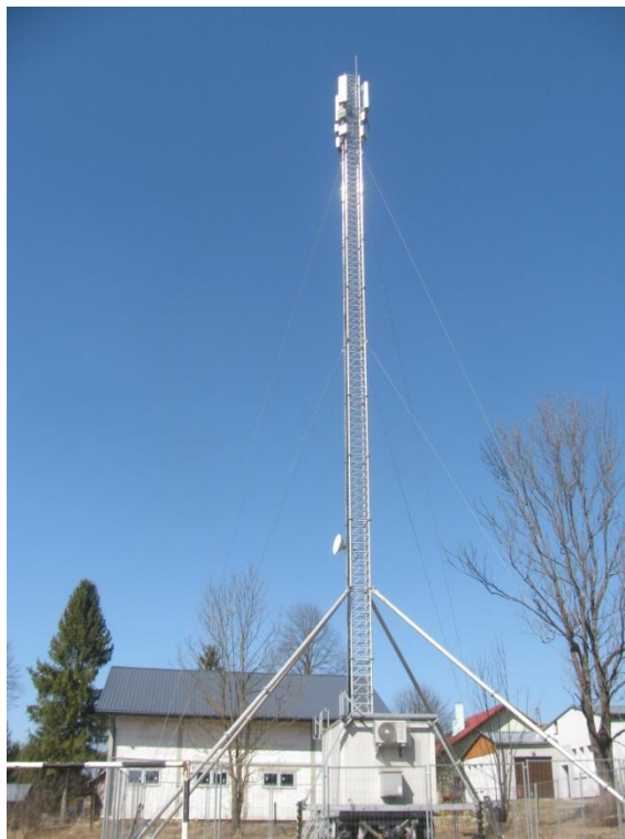
Zał. nr 1: Widok ogólny instalacji radiokomunikacyjnej.
